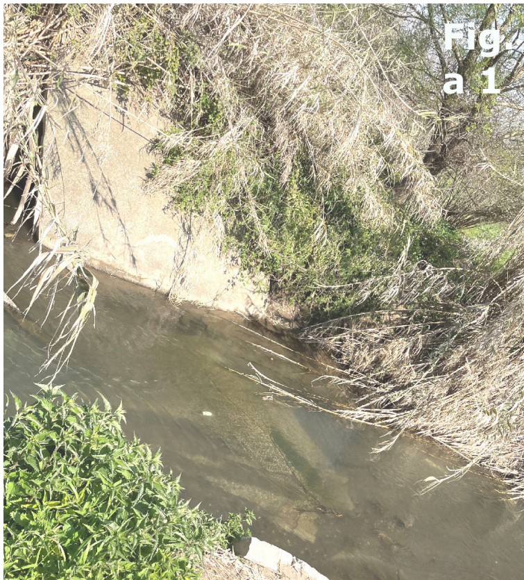
Fig. a 1 Il ponte distrutto nei pressi del Molino de' Monaci.
